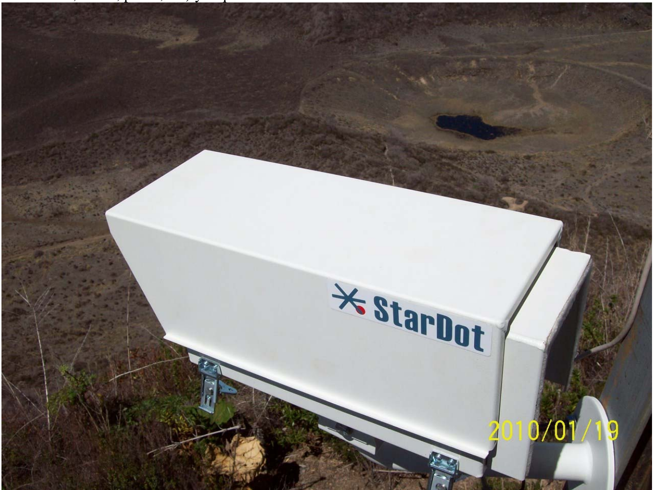
Vista de la cámara web montada en torre de comunicaciones ICE, en Cerro Porfía, V. Turrialba. Foto. A. Mata.
